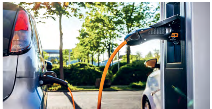
Bei Projekten zur Gebäudeversorgung wird auch das Thema E-Mobilität – hier eine Ladestation – mitgedacht.
