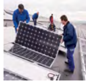
Neue Messe Stuttgart 3,8 MW Leistung, in Betrieb seit 2008
