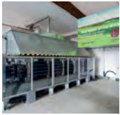
Haßfurt 1,3 MW Leistung, in Betrieb seit 2016
