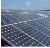
Dasing 1,5 MW Leistung, in Betrieb seit 2006
