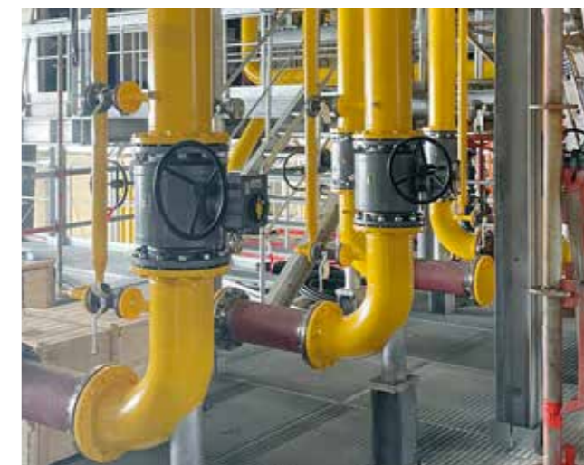
Rohrbaumontage in der neuen Energiezentrale – Heißwasser statt Dampf in der „Weißenburger Straße“.
