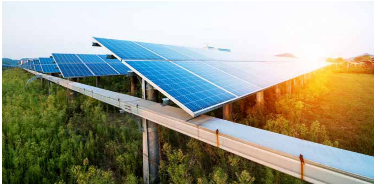
Freiflächen- und Agri-Photovoltaik
