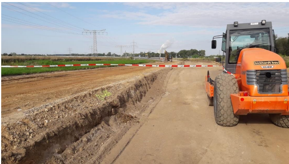
Sperrung nahe der Anschlussstelle Rötha / nördlich Espenhain (Autobahn GmbH des Bundes)
