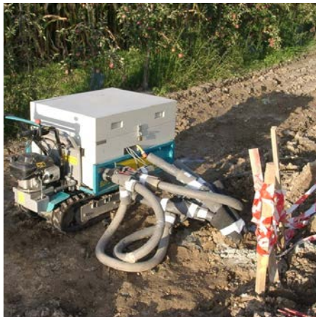
Neue Richtlinie VDI 4640 Blatt 5: Ermittlung von thermischen Eigenschaften des Untergrunds für die Auslegung einer Wärmequellenanlage (Bild: UBcG GbR)
