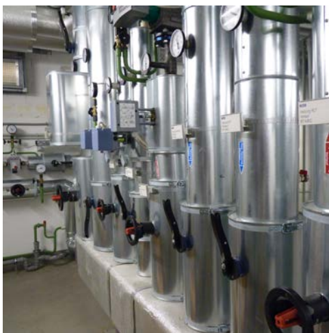
Neue Richtlinie VDI 2035 Blatt 1: Warmwasser-Heizungsanlagen vor Korrosion und Steinbildung schützen (Bild: VDI).
