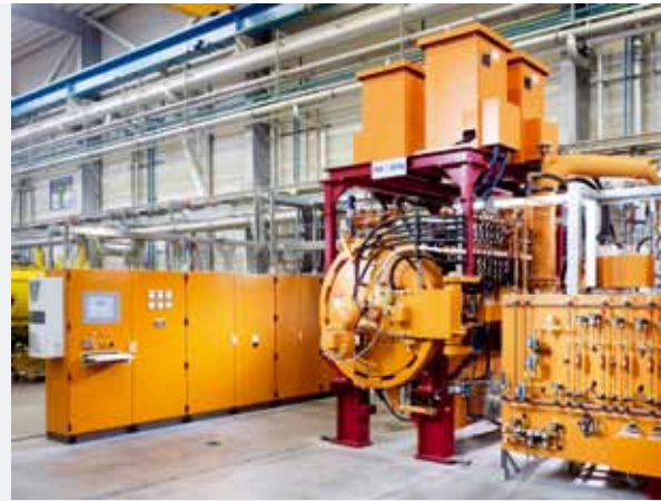
▮ Drucksinteranlage mit Schaltschrank
