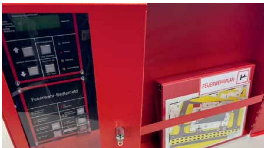
Das Feuerwehr-Bedienfeld einer Brandmeldeanlage
