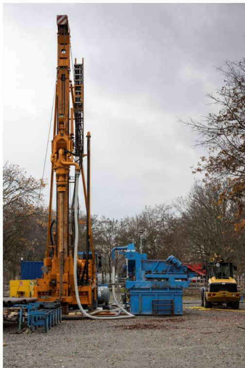
Foto: Bohranlage für Geothermie Rebstockbad Frankfurt. Quelle: Energierreferat / Foto: Hannes P. Albert
