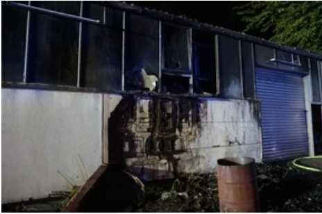
Brandschaden am Gebäude
