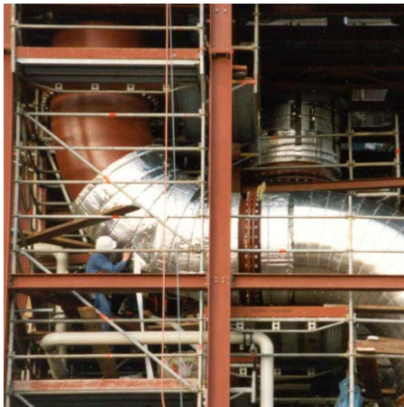
Neue Richtlinie VDI 4610 Blatt 2: Energieeffizienz betriebstechnischer Anlagen mit der richtigen Dämmung (Bild: G+H Isolierung)
