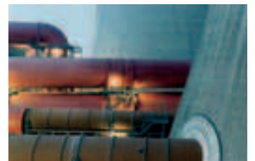
Reingasleitungen zu den Kühltürmen
