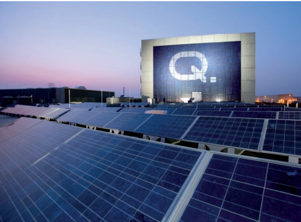
Solarmodule auf dem Dach des Hauptsitzes von Q-Cells in Thalheim
