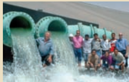
Libysche Pumpstation geht in Betrieb
