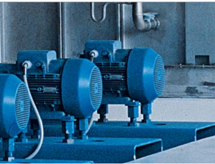
Spiralgehäusepumpen der Baureihe Etanorm in der Wärmeversorgung einer Industrieanlage
